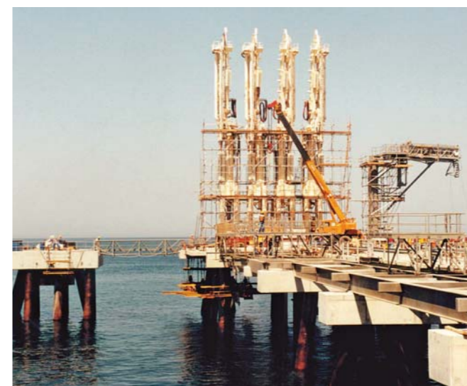
Oman LNG Loading Arms Assembly
